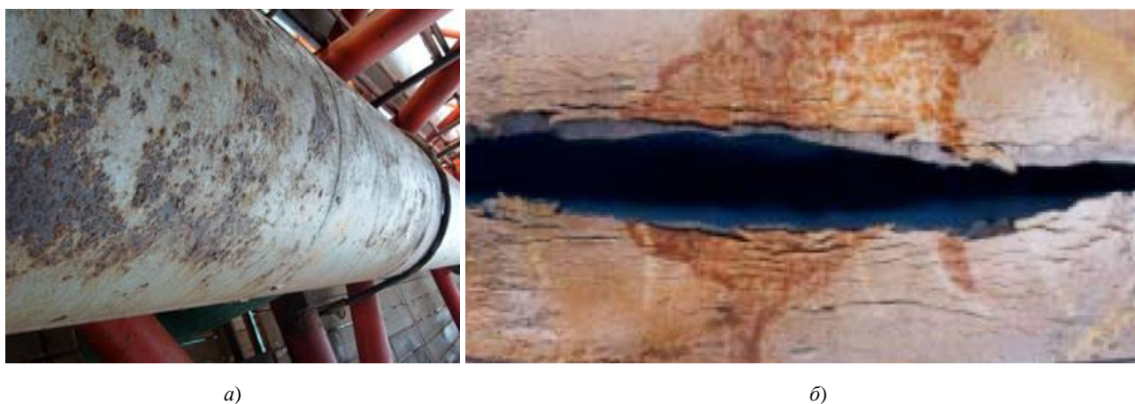
Рис. 1. Коррозионные повреждения стенки трубы: питтинговая коррозия (а); стресс-коррозия (б)
